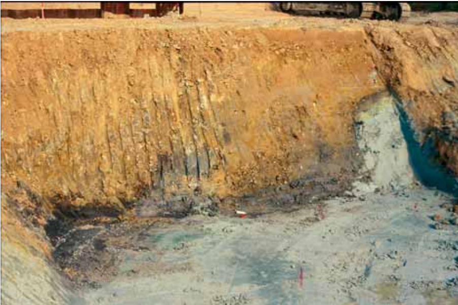
Abb. 9. Mergelaufpressung in der ICE-Trasse. Der unter dem Grundwasser führenden braunen lehmigen Kies liegende vernässte graue Mergel ist in den Kies aufgepresst worden und bildet regelrechte Mergeldämme, die das Grundwasser im Kies „kammern“.
